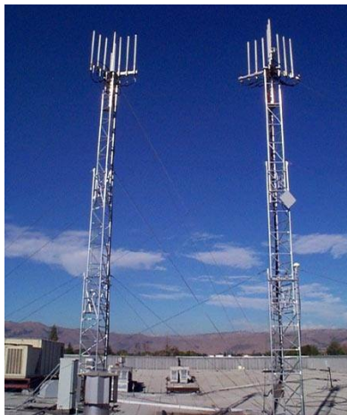
Figura 6. Antenas de comunicación WiMAX.
